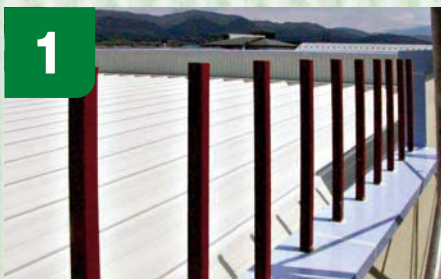
1 欄干のピン下地材です。根元に止水効果のあるコーキングをします。
