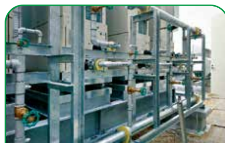
ユニット架台
