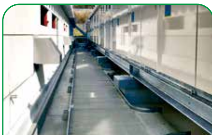
キュービクル架台
