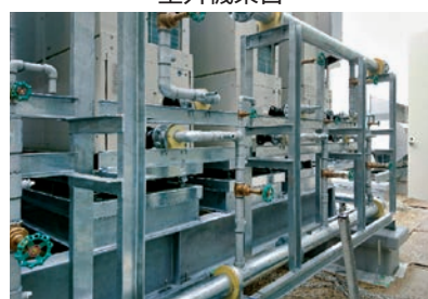
ユニット架台
