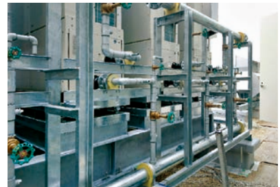
ユニット架台
